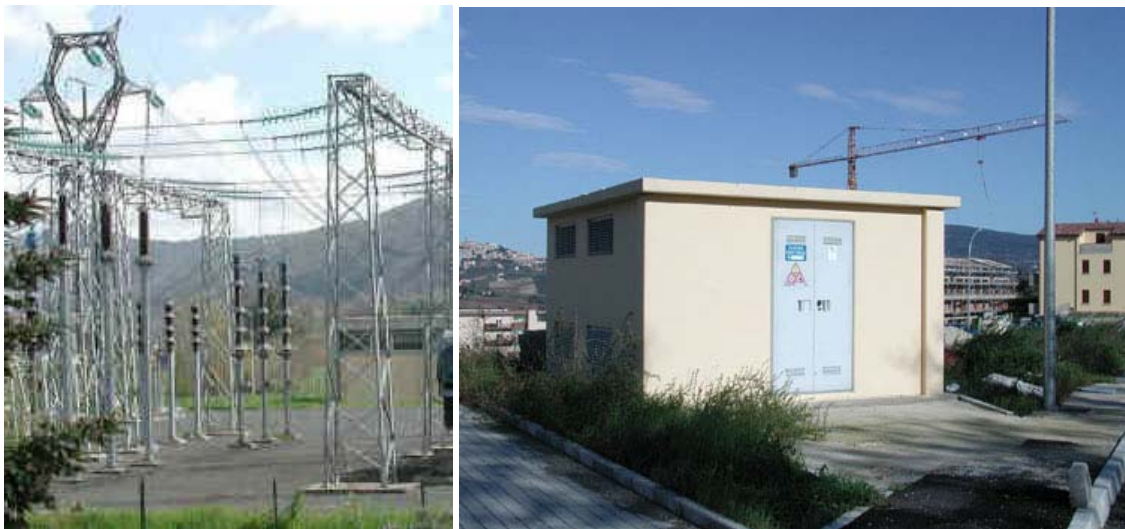
Fig. 3 – Esempi di stazione e cabina di trasformazione
